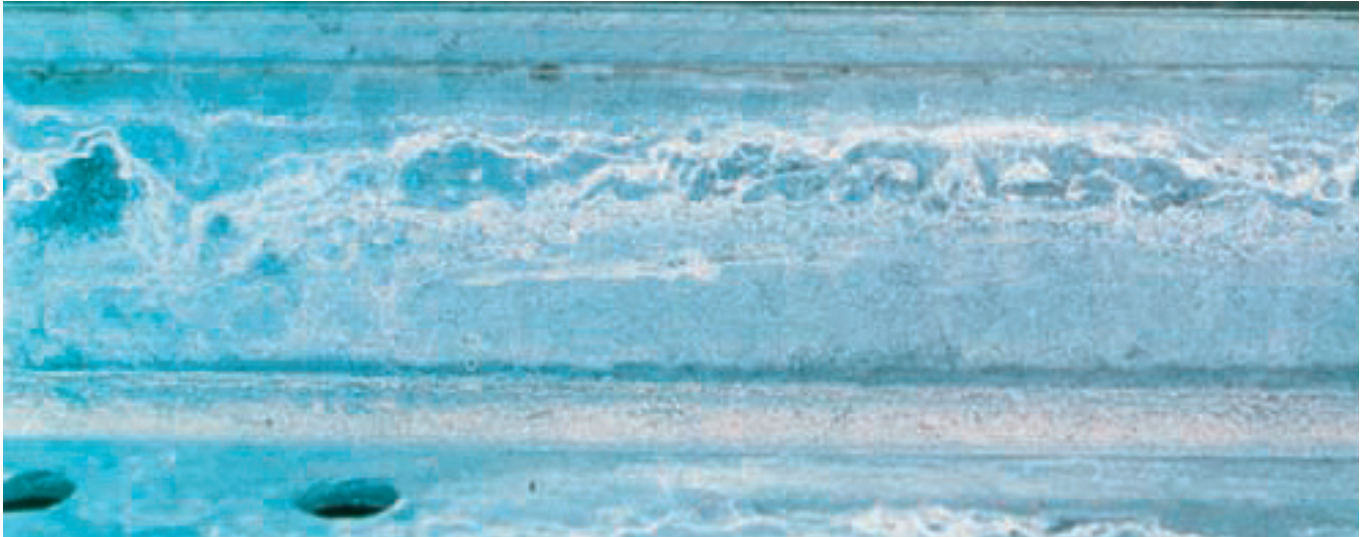
Figur 1. Hvidrust dannet på tæt sammenlagte vinkeljern efter udendørs oplagring.
